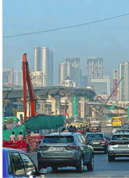
Straßen- und Baustellenszene aus Mumbai (links): Die zweitgrößte Stadt Indiens ist auch das Finanzzentrum des Landes.
